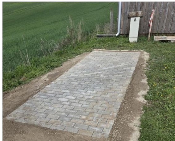
Fred Büttner hat kürzlich die Ausstellungsfläche fertiggestellt, auf der die Mahlsteinsammlung des Museums Angermünde ausgestellt werden soll. Im Augenblick befinden sich die 21 Steine noch bei O. Schwers in Günterberg.
